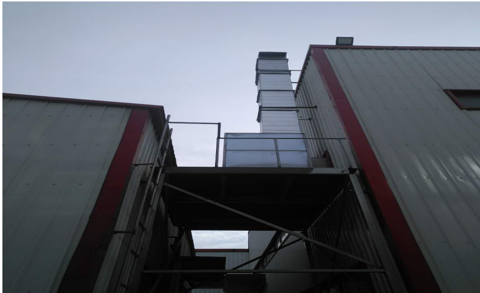
图 4-1-9 注塑成型 15 高排气筒 P3、活性炭设备
