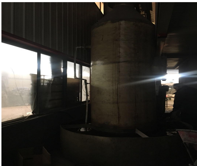
图 4--1-4 生物质固化炉废气净化设备
